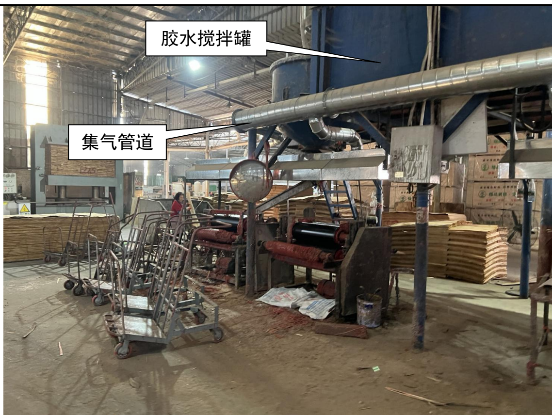
图 2-6 现有项目废气收集设施设置情况
